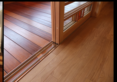
防風・塵効果を考えた敷居レール
